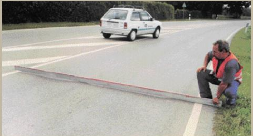
Nyomvályús burkolat marás előtt
