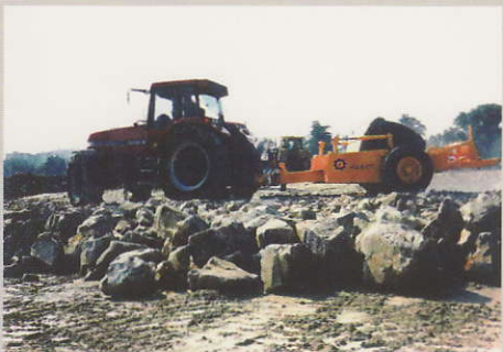
Behordott kő tömörítő törése
